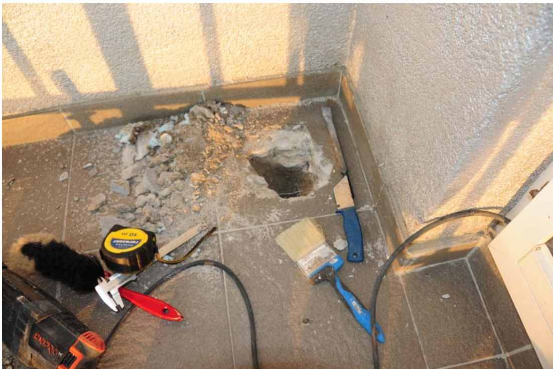
Рис. 4.1. Загальний вигляд конструкцій, підлоги малого балкону (24 поверх).
